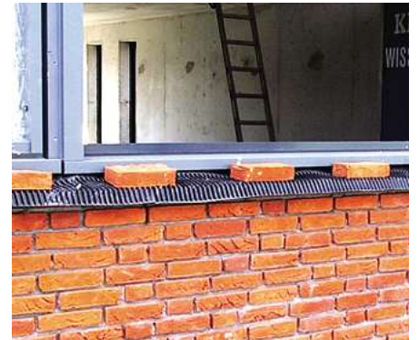
Tijdelijke waterslag tegen invrengen in het metselwerk.
